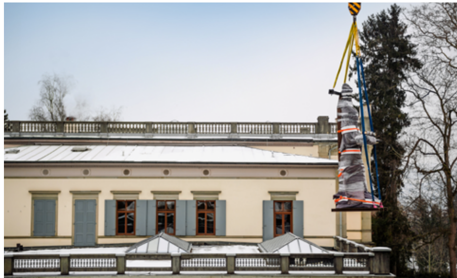
Langsam schwebt die Statue ihrem Standort entgegen. Da dabei das Dach des Museumscafés zu überqueren war, musste das Lokal aus Sicherheitsgründen kurzzeitig evakuiert werden.
